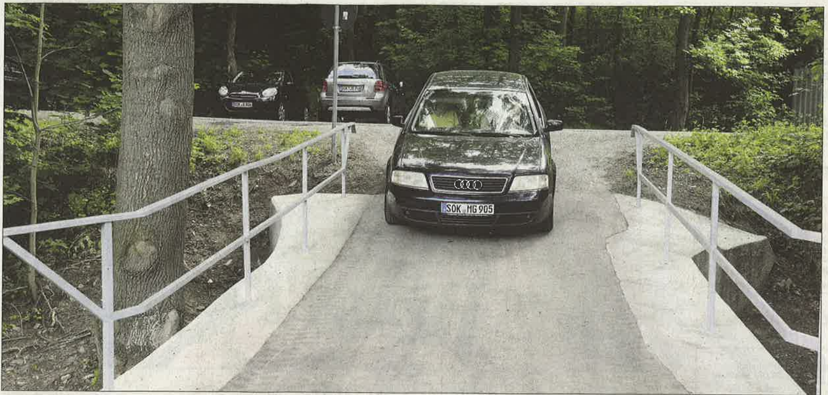
Die Brücke zur Kleingartenanlage „In den Falkenhainswiesen“ in Neustadt wurde für rund 30 000 Euro saniert und wieder für die Nutzer freigegeben. Nach dreieinhalb Jahren darf sie wieder von Pkw befahren werden. Foto: Peter Cissek
